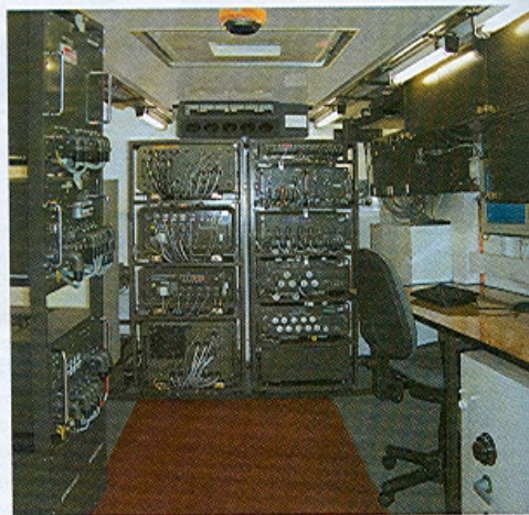
Wnętrze aparatuwni komutacyjno-dostępowej (AK-D).
